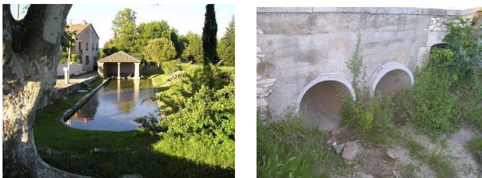
Illustration 10 : Passage du Nizon sous la RD26 au droit du lavoir (sous BV 4)
